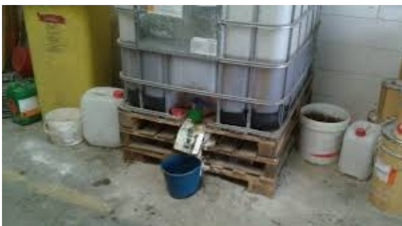
Figura 13; sistema de recogida de vertidos deficiente
